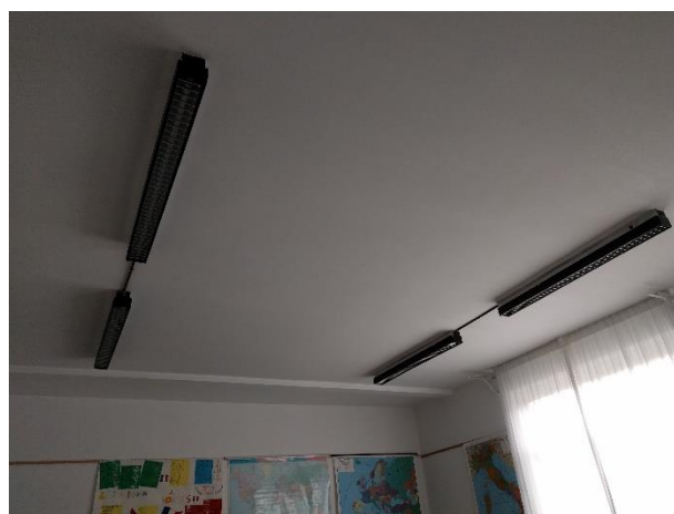
Figura 4.15 - Particolare dei corpi illuminanti nelle aule
