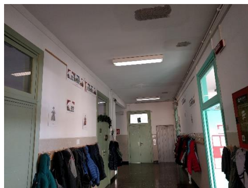
Figura 4.14 - Particolare dei corpi illuminanti ubicati nel corridoio e nella palestra
