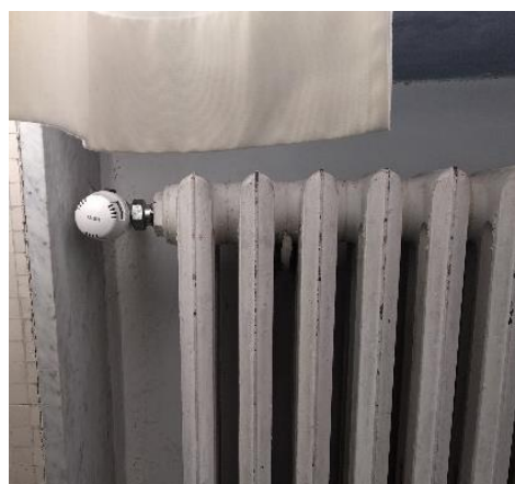
Figura 4.8 – Valvole termostatiche sui radiatori
