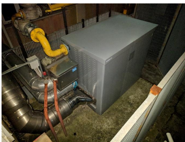
Figura 4.12 - Particolare del generatore di calore a condensazione
