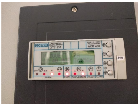
Figura 4.7 - Particolare della centralina di controllo in centrale termica (telegestione)
